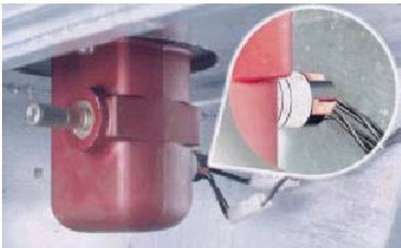
Dispositivo para controlar a presença de gás SF 6 .
